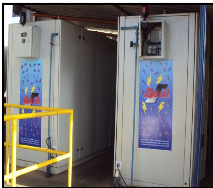
Figura 13: Visão dos painéis de obtenção do ozônio
