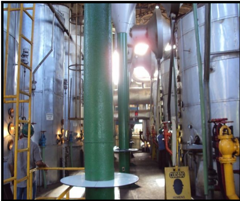
Figura 17: conjunto de Cozedores de múltiplos efeitos da Usina Monte Alegre
