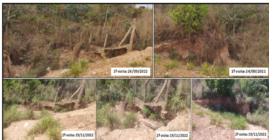
Figura 13 – Imagem da erosão com todas as vistas.
