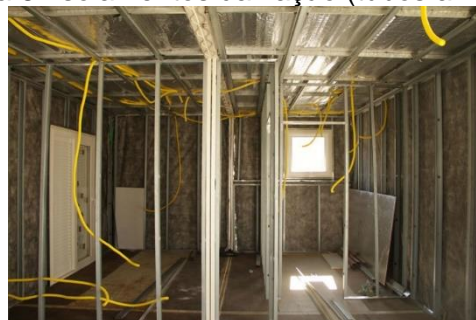
Figura 8: Isolamentos da fiação (tubos amarelos)
