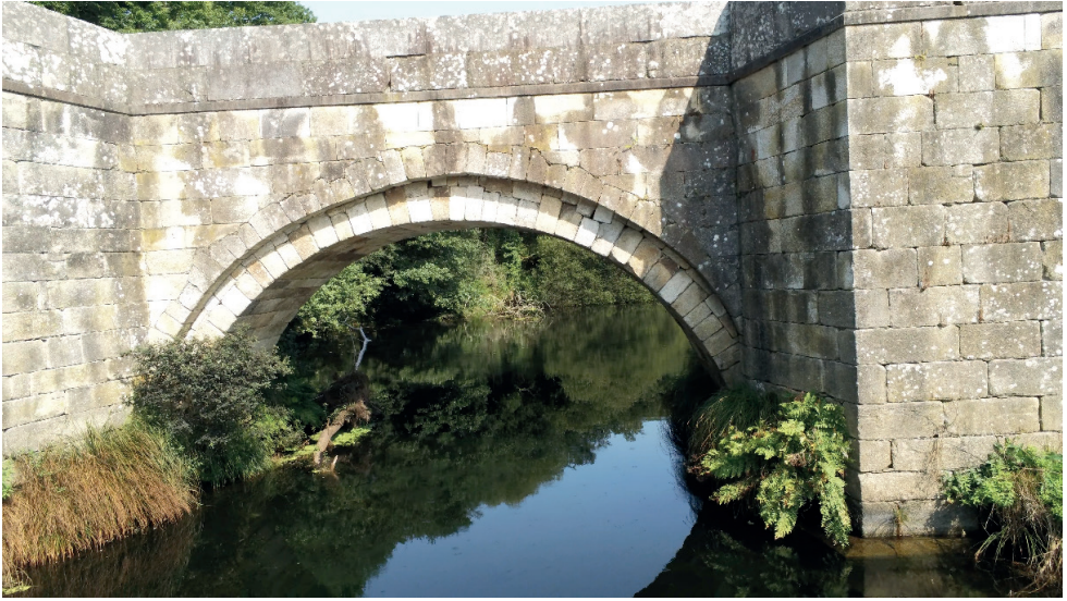
Figura 4: Vista general de uno de los arcos mayores del Puente de Brandomil, en imagen captada con el dron multi rotor empleado en la inspección desde el lado aguas abajo del Puente (fotografía del autor).
