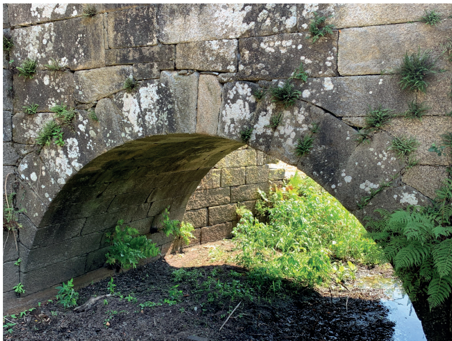
Figura 9: Vista general del arco más pequeño del Puente de Brandomil, visto desde el lado aguas arriba, en imagen captada con el drone multi rotor empleado en la inspección, donde se puede observar la abundante presencia de vegetación enraizada en los múltiples elementos (fotografía del autor).
