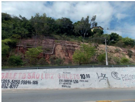
Figura 12: Erosão de base do talude
