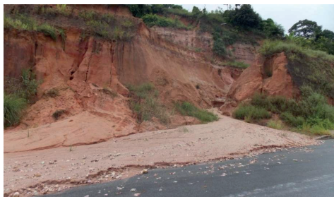
Figura 27: Pista parcialmente invadida por deslizamento
