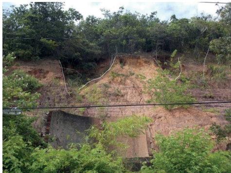
Figura 11 : Desprendimento de terra
