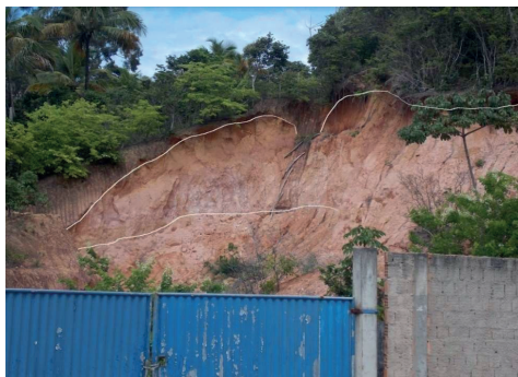
Figura 14: Mistura de deslizamento rotacional com queda
