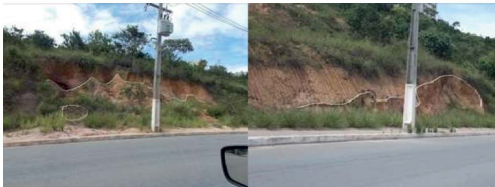
Figura 18: Erosão do tipo subterrâneo
