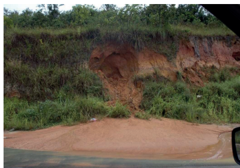
Figura 16: Erosão do tipo “ pipping ”
