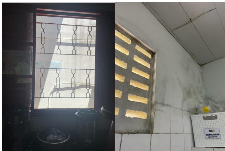
Figura 14 – Ausência de telas nas áreas de armazenamento e preparação de alimentos.
