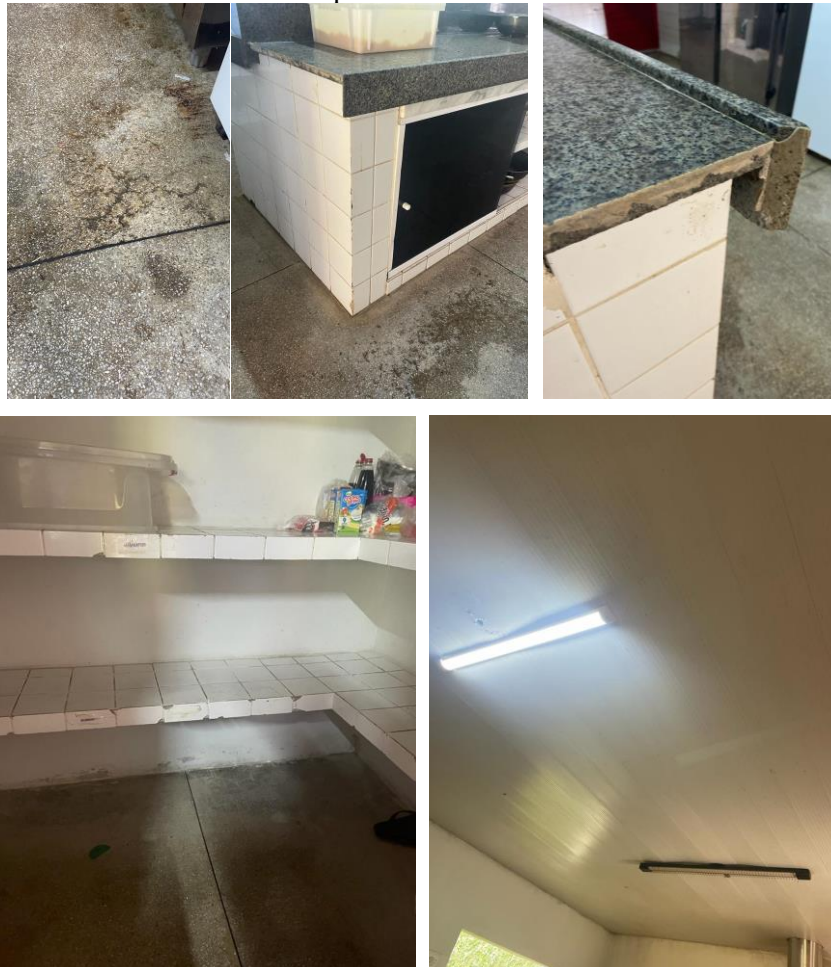
Figura 12- Estado de conservação do piso, bancadas e prateleiras. Presença de rachaduras e descascamento. Luminária quebrada dificultado luminosidade no local.
