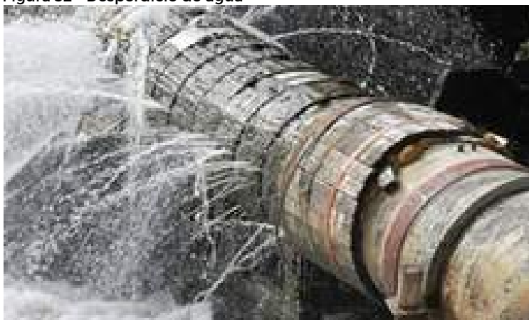
Figura 32 - Desperdício de água
