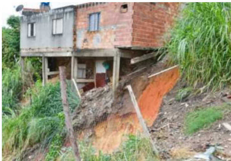
Figura 10: Moradia em risco
