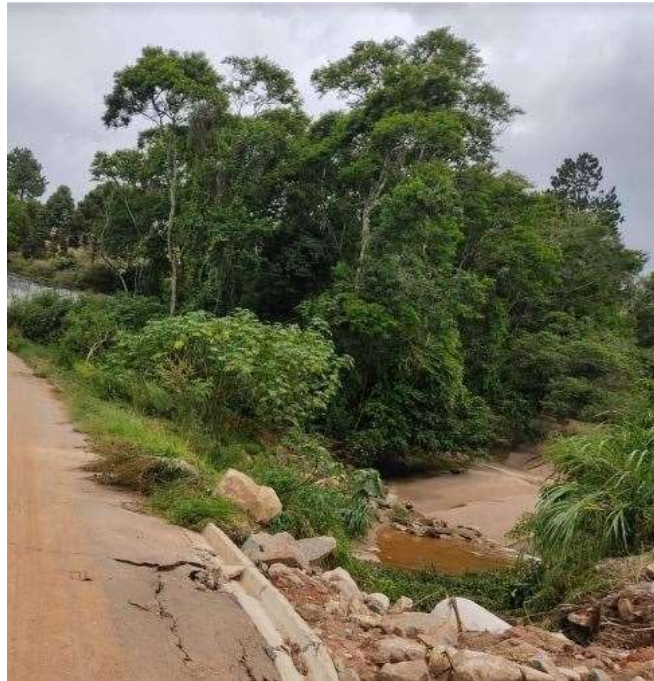
Figura 14: Estragos causados pela força da chuva
