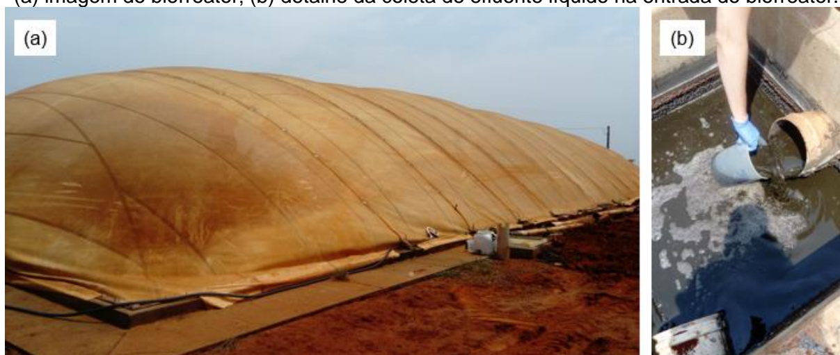
Foto 1 - Biorreator anaeróbico operando no tratamento de efluente líquido de suinocultura: (a) imagem do biorreator; (b) detalhe da coleta de efluente líquido na entrada do biorreator.
