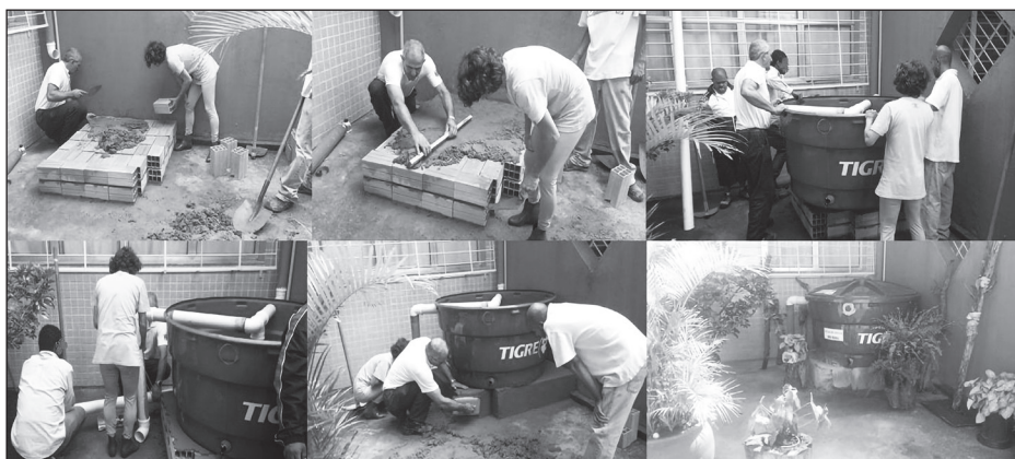
Figura 2 – Instalação do sistema de cisternas e captação de água da chuva para a rega da horta didática
