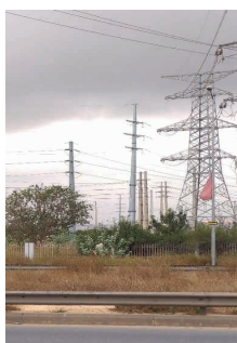
Figura 10. Poste de AT, 60 kV inclinado
