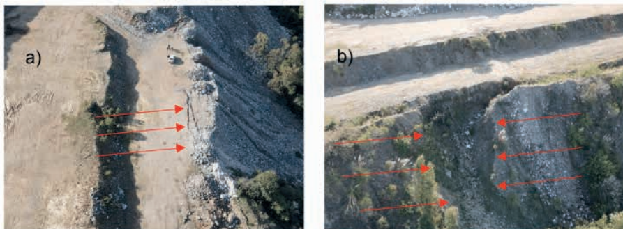
Figura 15 – Fotos áreas da DCE R4, (a) trincas observadas na crista do talude (b) erosões na face do talude da pilha devido a drenagem ineficiente.
