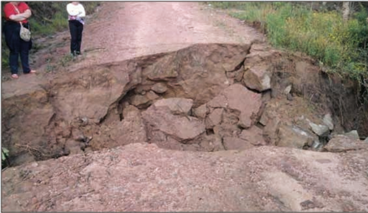
Figura 14: Erosão em via pública devido às fortes chuvas no interior de Arroio do Padre. Fonte: Jornal Diário Gaúcho (2010).
