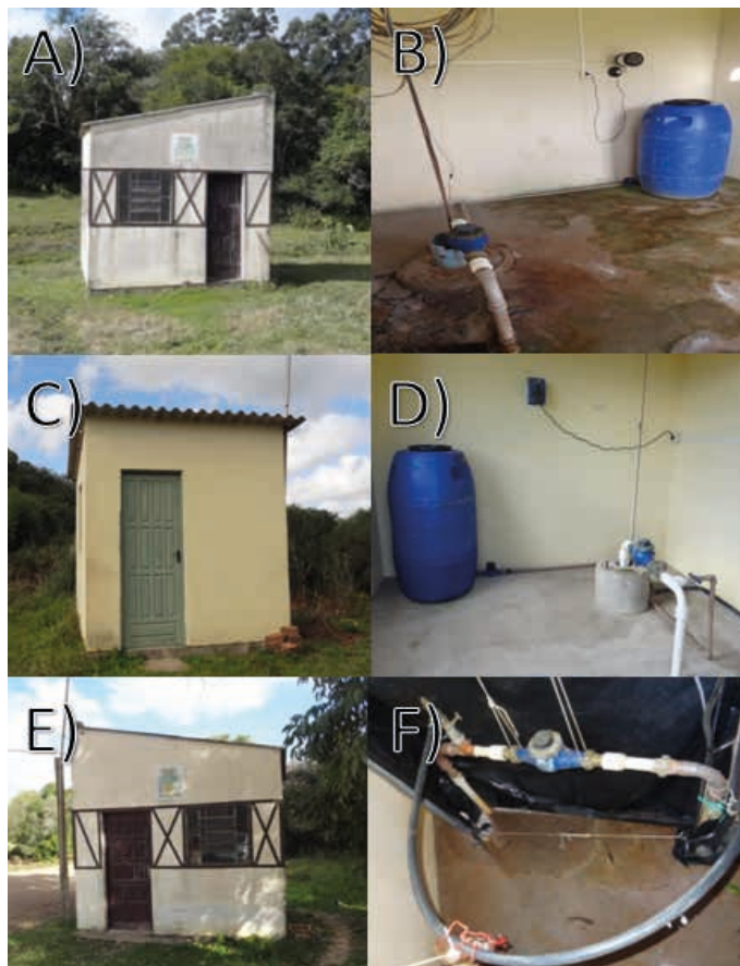
Figura 52: Imagem da estrutura dos poços de captação de água para o abastecimento municipal. A) Estrutura de proteção do Poço 1. B) Captação do Poço 1. C) Estrutura de proteção do Poço 2. D) Captação do Poço 2. E) Estrutura de proteção do Poço 3. F) Captação do Poço 3.
