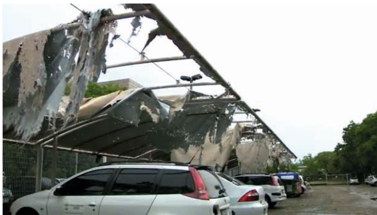
Figura 16: destruição do estacionamento da câmara de vereadores de POA. Fonte: G1 (2014).
