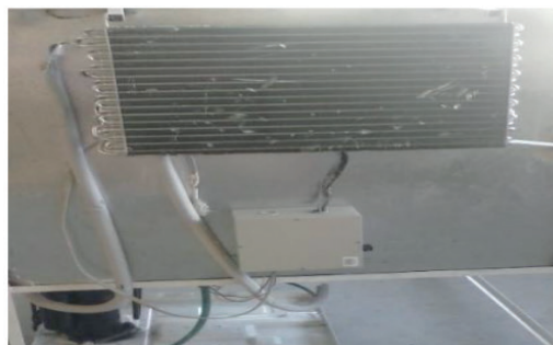
Figura 2. Vista posterior - cámara de frío-condensador
