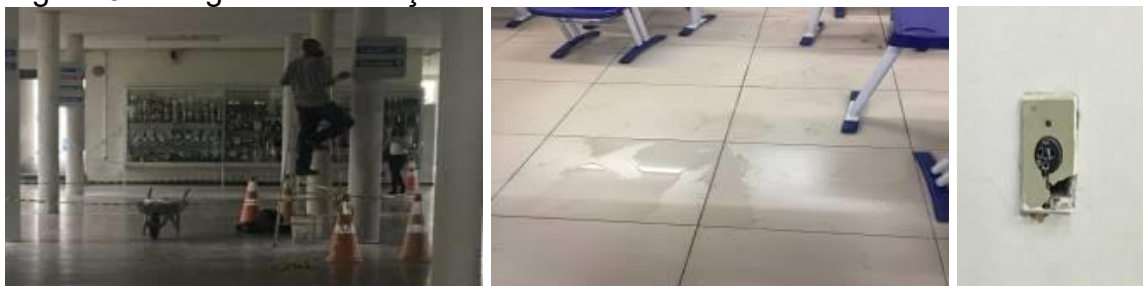
Figura 3 - Imagens de condições de risco no Ifes-Vitória.
