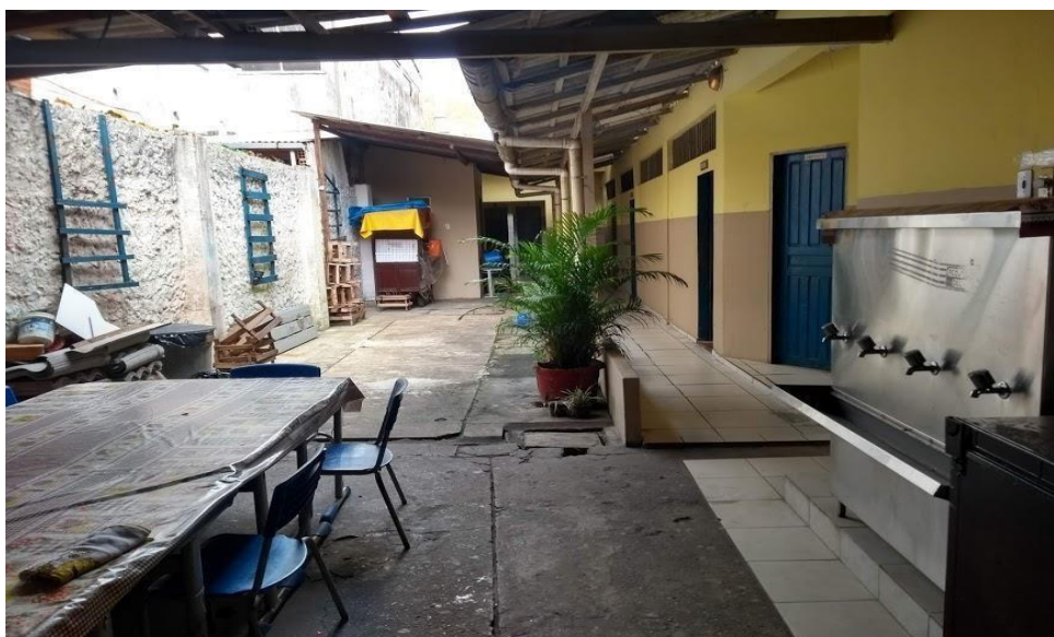
Figura 13 – Precárias condições estruturais da E. E. E. F. “Candido Horácio Evelin”
