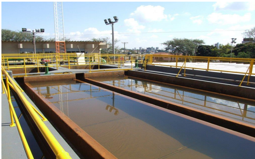
Estação de Tratamento de Água de Cascavel
