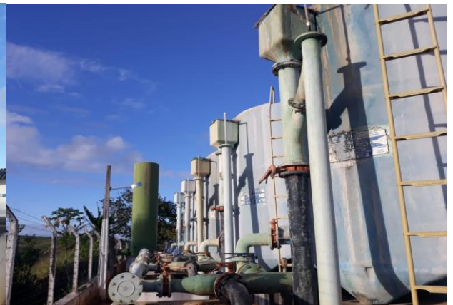
Figura 2: Tubulações de entrada e saída dos filtros. Fonte: Moreira, 2020.
