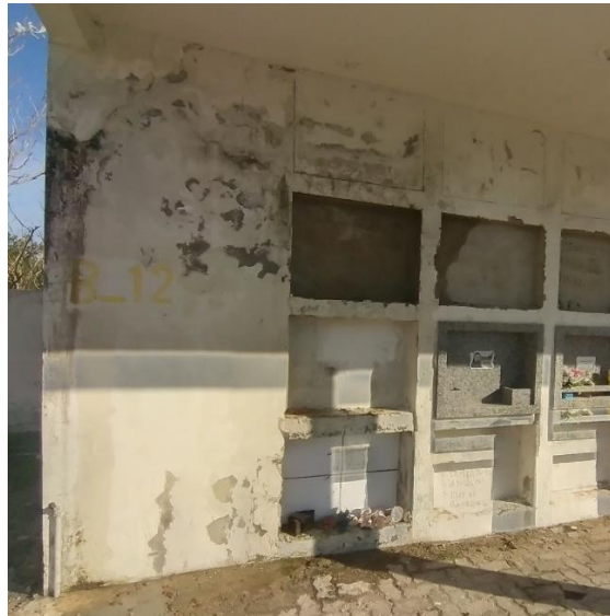
Figura 2: infiltração na parte superior das gavetas
