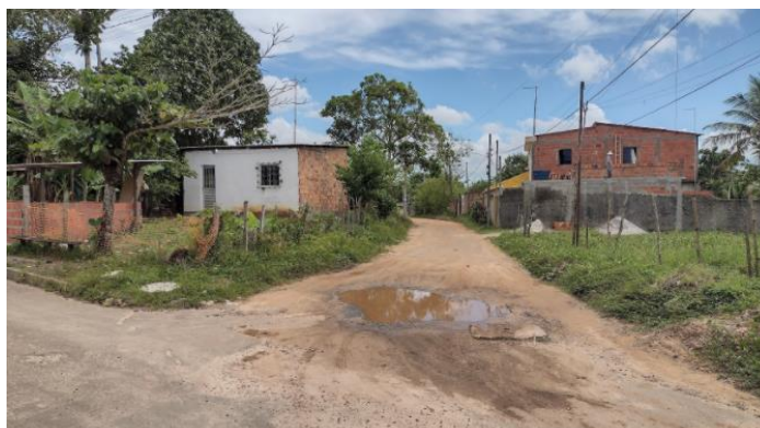
Figura 19 – Rua sem asfalto no Parque Verde II
