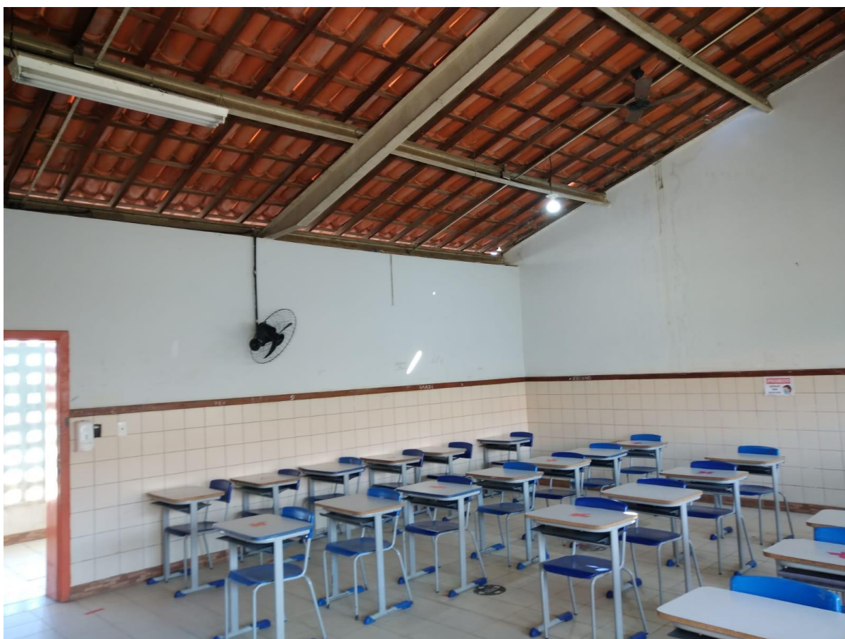
Figura 8 - Iluminação das salas
