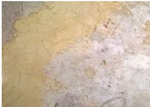
Figura 8 – Detalhe da parede do sótão indicativo da constituição de óleo de baleia
