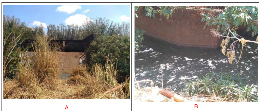
Figura 3 – (A) Condições do 1º bolsão de infiltração / contenção do sistema de drenagem pluvial; (B) Características da água do mesmo bolsão: cor preta e textura de lodo.
