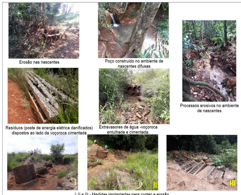
Figura 4 – Condições da cabeceira do córrego Três Marcos – erosões; mudança de gradiente; aprofundamento da superfície da área brejosa (poço); resíduos sólidos dispostos em APP
