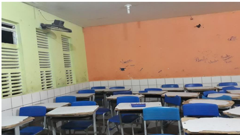
Foto 1- Sala de aula com cadeiras quebradas e paredes desgastadas.
