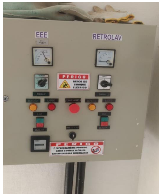
Figura 29 - Quadro de comando da ETR Guadalajara
