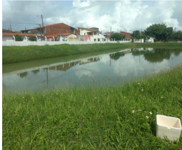
Figura 49 - Estado da pintura das estacas e do muro do entorno da ETER Guadalajara
