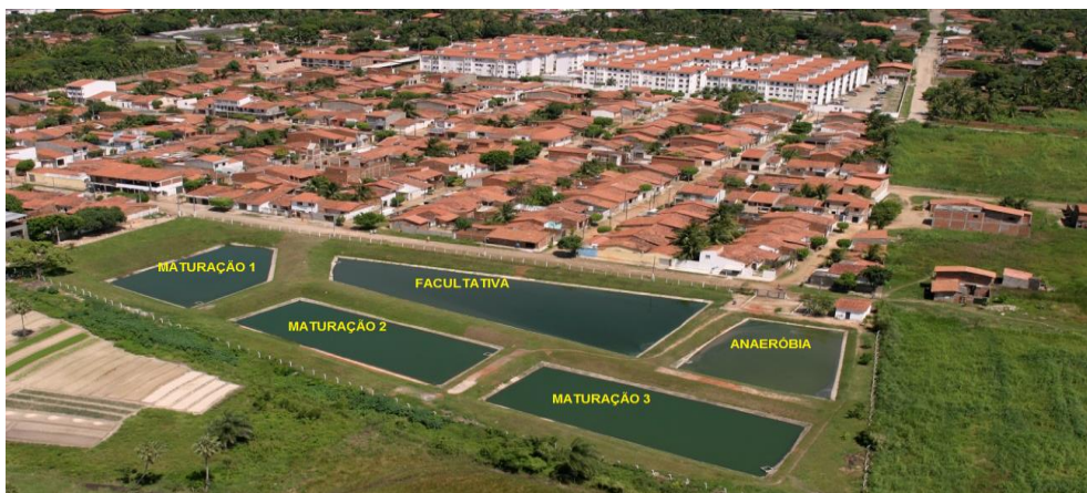
Figura 15 - Vista espacial das 5 lagoas de estabilização da ETE Guadalajara
