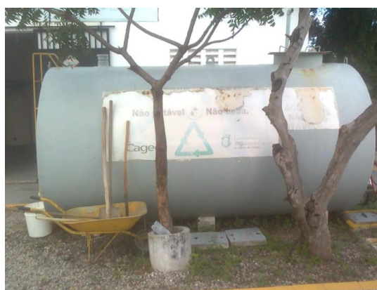
Figura 46 - Tanque de armazenamento da água de reúso da ETR Guadalajara
