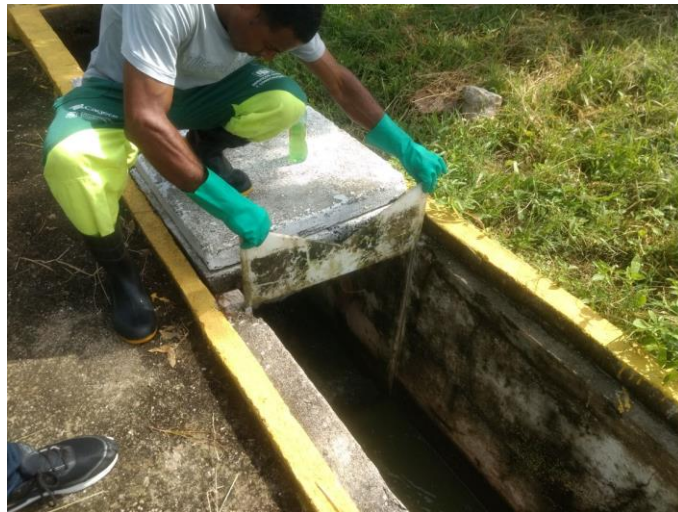
Figura 31 - Comporta para iniciar o processo de tratamento de reúso
