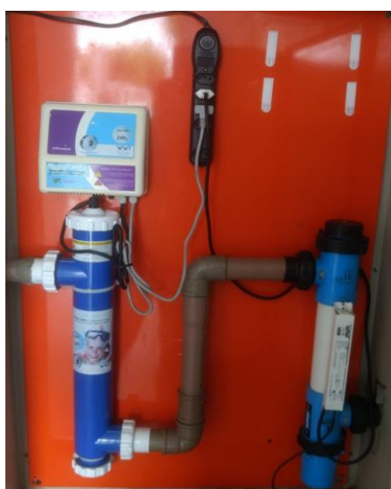
Figura 38 - Aparelho responsável pela radiação ultravioleta da ETR Guadalajara
