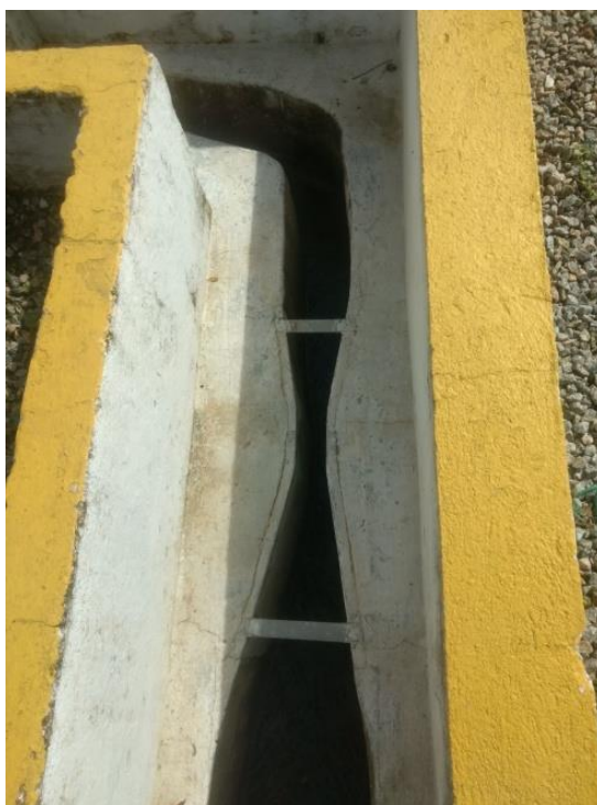
Figura 19 - Calha Parshall da ETE Guadalajara
