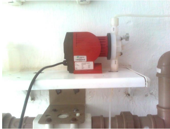
Figura 41 - Bomba dosadora de cloro empregada na ETR Guadalajara
