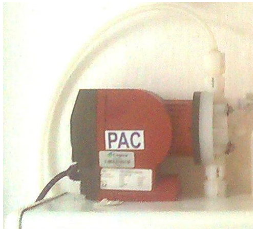
Figura 33 - Bomba dosadora de policloreto de alumínio
