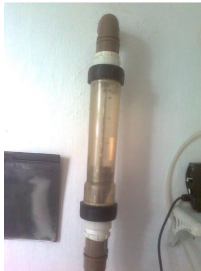
Figura 42 - Medição da vazão do efluente tratado
