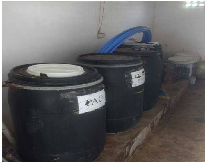
Figura 47 - Armazenamento dos produtos químicos usados no processo de tratamento para reúso
