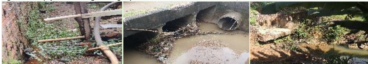
Figura 24. Despejo direto de esgoto em igarapés na zona urbana de Ji-Paraná-RO, 2017/2018.
