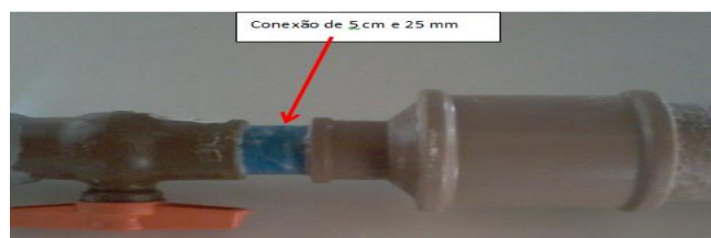
Figura 2 – Reservatório ligado ao registro por meio de tubo de 25 mm (azul) - autoria própria
