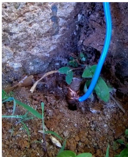
Figura 3: Haste de aterramento de vergalhão para construção. Fonte: próprio autor.
