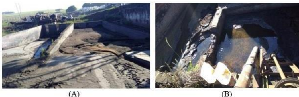
Figura 01: (A) Decantador; (B) Saída do decantador.
