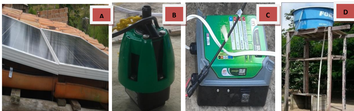
Figura 02 – (A) Placas fotovoltaicas; (B) Bomba d'água Vibratória; (C) Driver; (D) Caixa d'água.
