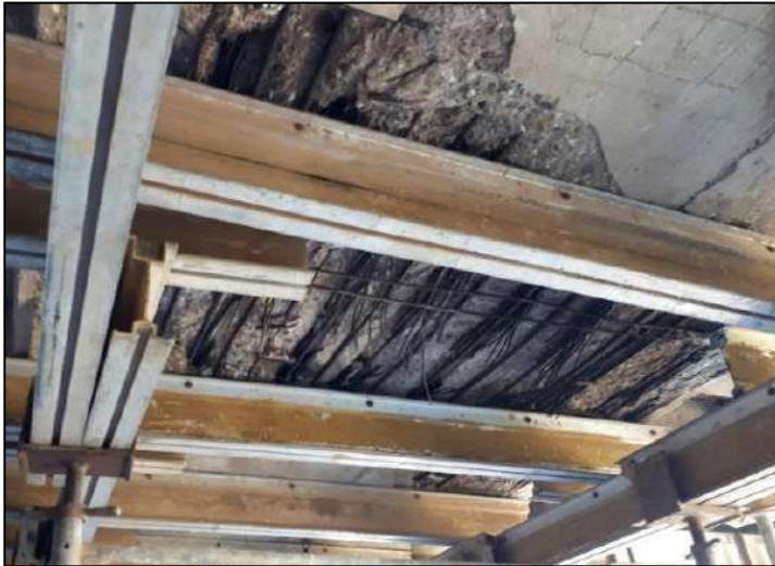
Figura 04: Rompimento dos cabos de protensão.
