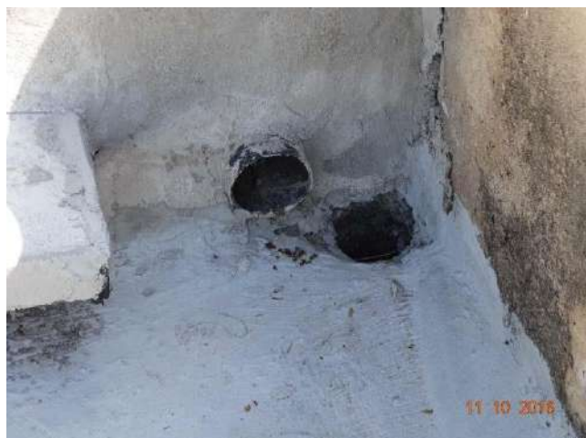
Figura 10 – Ductos de água sem ralo abacaxi.
