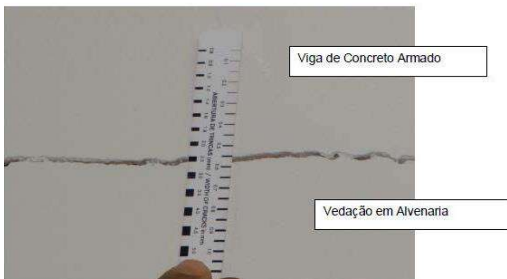
Figura 11 – Rachadura na parede externa da sala do cofre.
