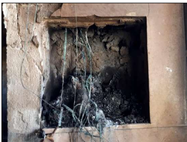
Figura 02: Detalhes do quadro de energia.
