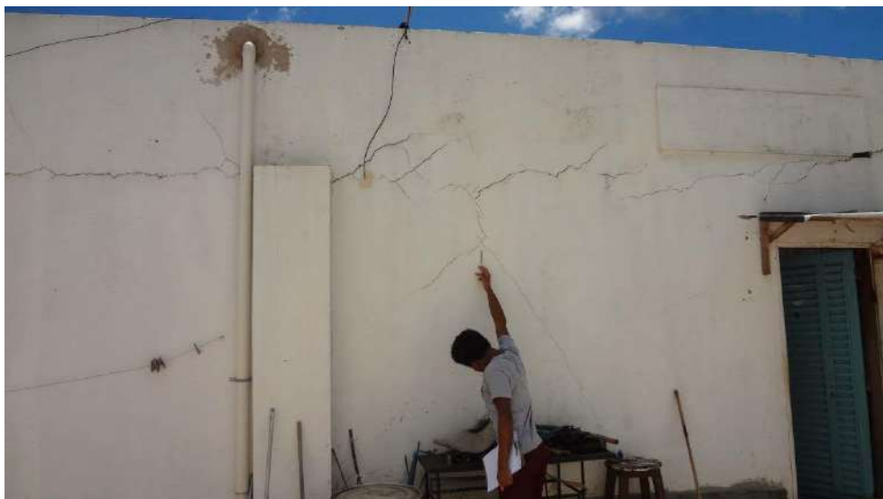
Figura 06 – Fissuras na fachada lateral esquerda da edificação.
