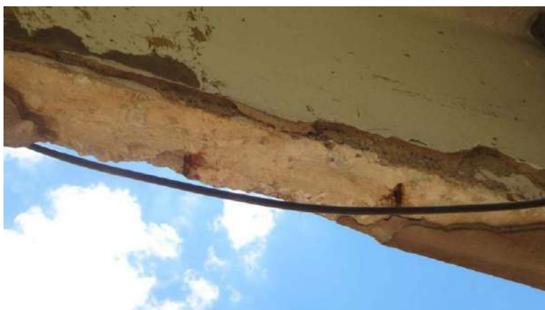
Figura 04 – Armadura exposta e corroída na platibanda.
