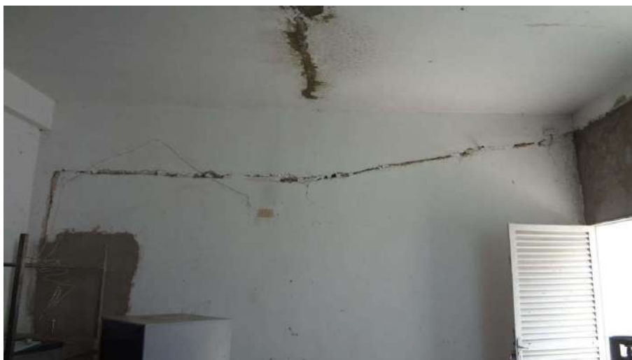
Figura 10 – Rachadura na junção da viga com parede de alvenaria e com o pilar.
