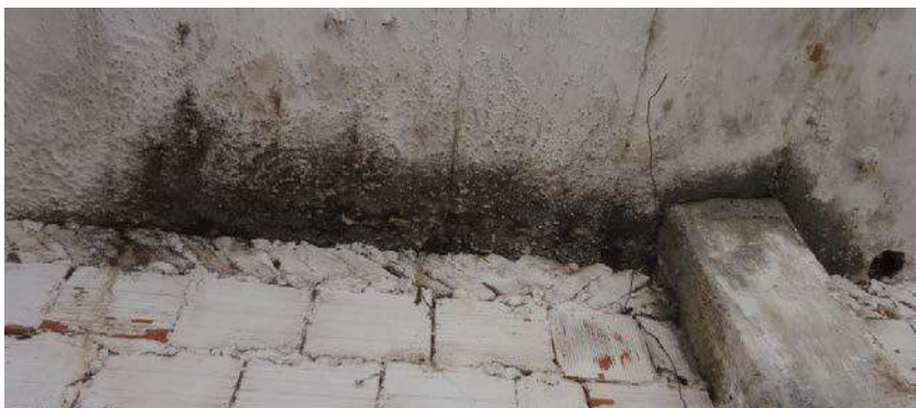
Figura 07 – Mancha de infiltração na laje e no pilar.
