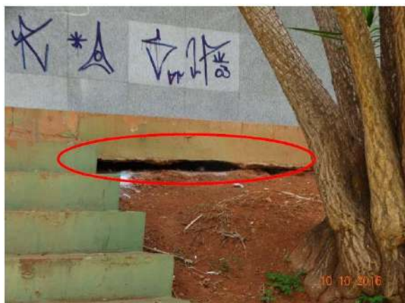
Figura 22 – Falha na parte interior da calçada externa na fachada norte
