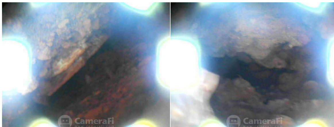
Figura 26 – Parte interna abaixo da calçada com espaços vazios devido a movimentação do solo.
