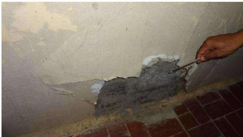
Figura 09 – Deslocamento de revestimento argamassado.
