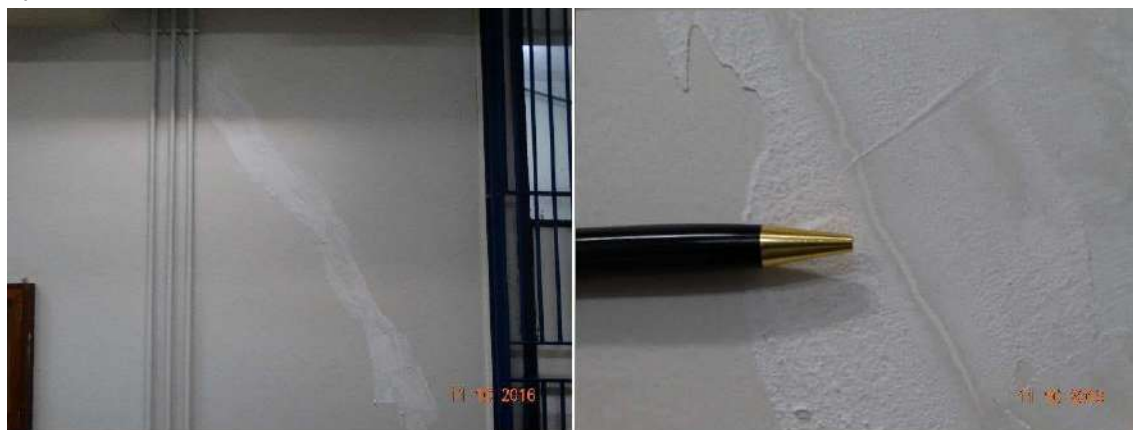
Figura 19 – Monitoramento da rachadura na alvenaria interna no canto esquerdo da sala do cofre, aparentemente não ativa.
