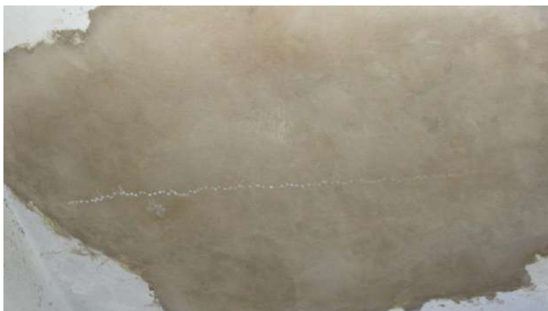
Figura 11 – Laje com eflorescência.
