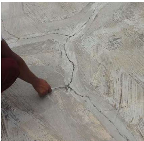
Figura 03 – Trincas na laje de piso.
