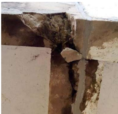
Figura 05 – Junta de dilatação deteriorada na platibanda.
