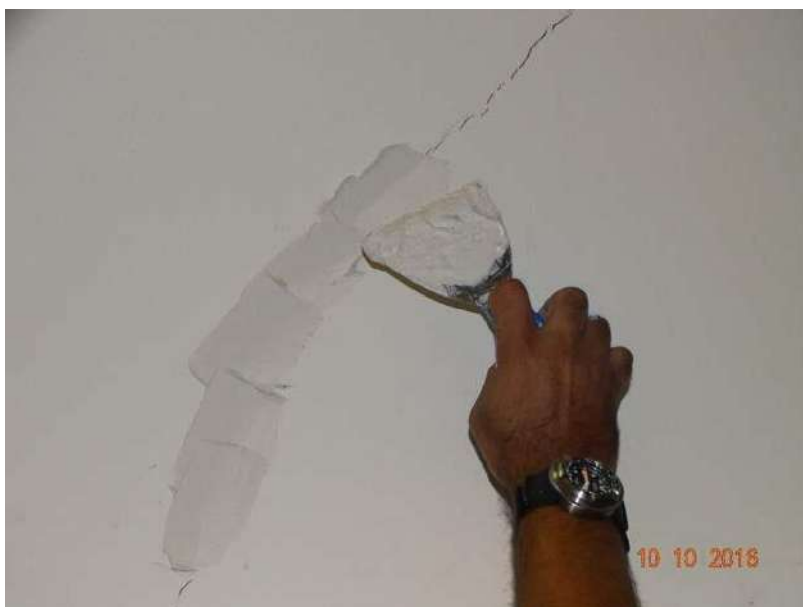
Figura 14 – Trinca em alvenaria da edificação.
