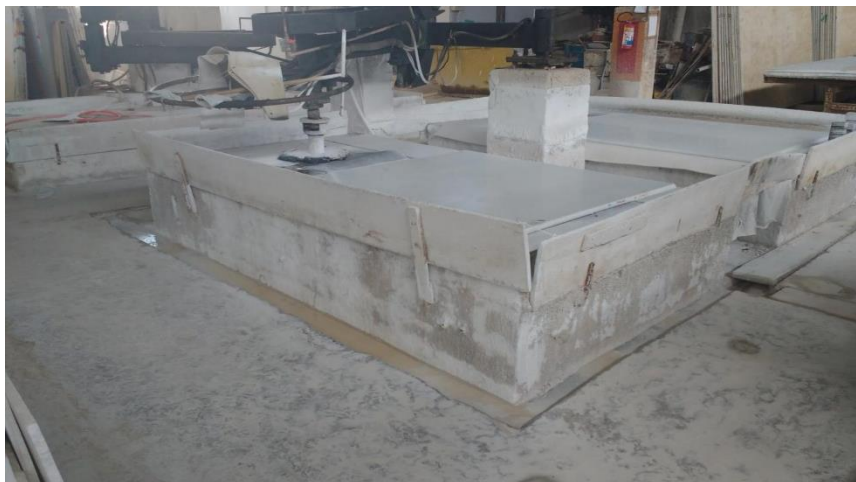
Figura 2 - Canaletas para escoamento do efluente oriundo do polimento das chapas.
