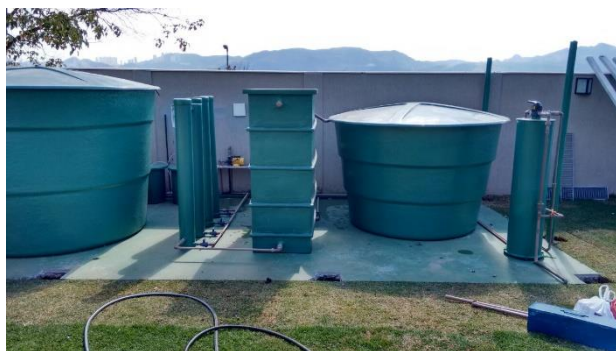
Figura 2 – Estação de tratamento de águas cinzas.
