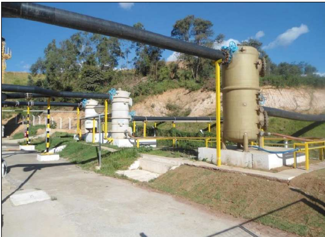
Figura 9 – Filtros para remoção de condensado. Unidade de captação de biogás no Aterro Sanitário Caieiras (SP). Fonte: Acervo pessoal do autor.
