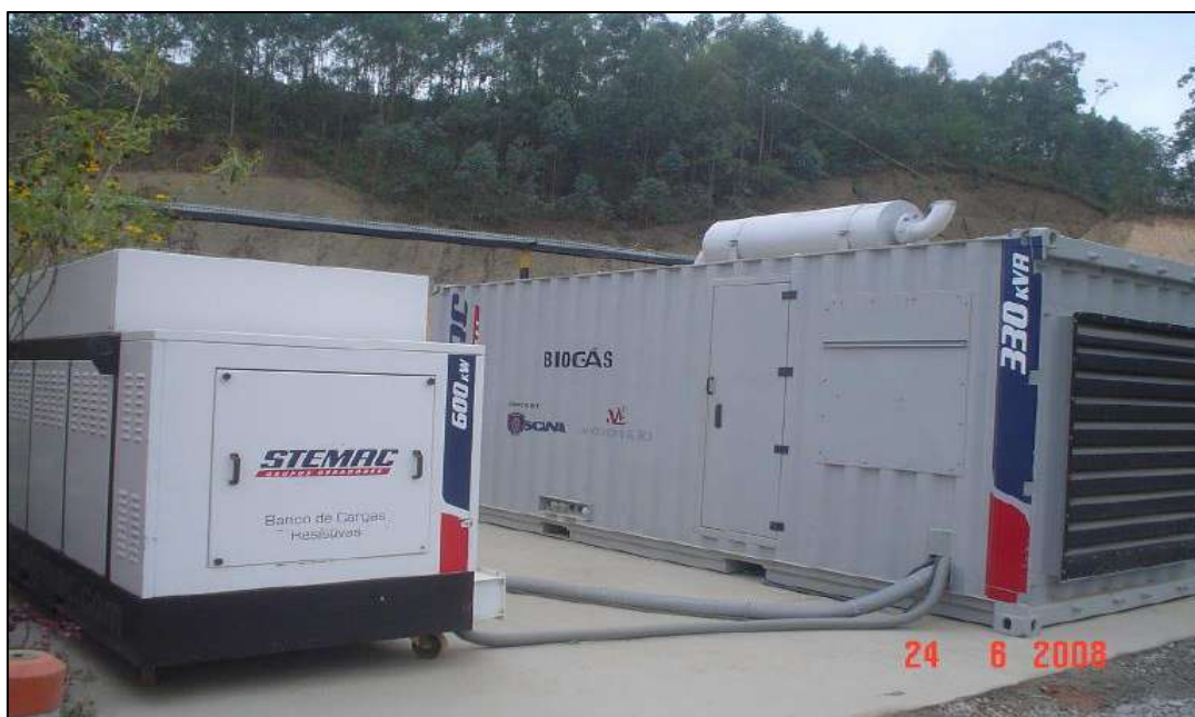
Figura 10 – Motogeradores a biogás para geração de energia elétrica no Aterro Sanitário Caieiras (SP). Fonte: Acervo pessoal do autor.
