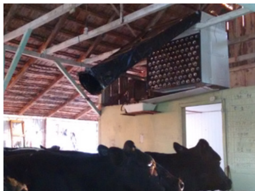
Foto 6 - Climatizador em operação
