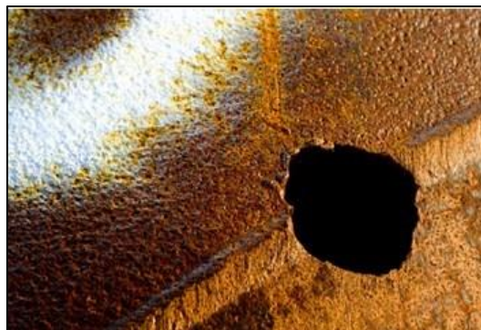
Figura 41: Corrosão eletrolítica em uma tubulação de petróleo. Fonte: https://betaeq.com.br/index.php/2018/11/27/os-tipos-de-corrosao/ , acessado em 05 de julho de 2019.
