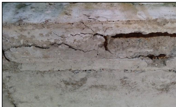
Figura 40: degradação dos componentes do concreto.
