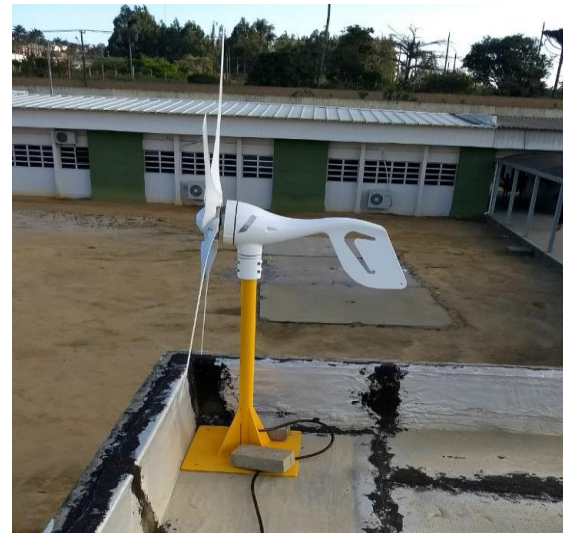
Figura 10 (b). Aerogerador instalado.
