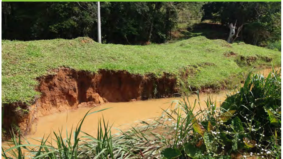
Foto 5: A margem direita do rio Pardo encontra-se sem mata ciliar, com pastagem e expressivas marcas de pisoteio do gado e erosão significativa.
