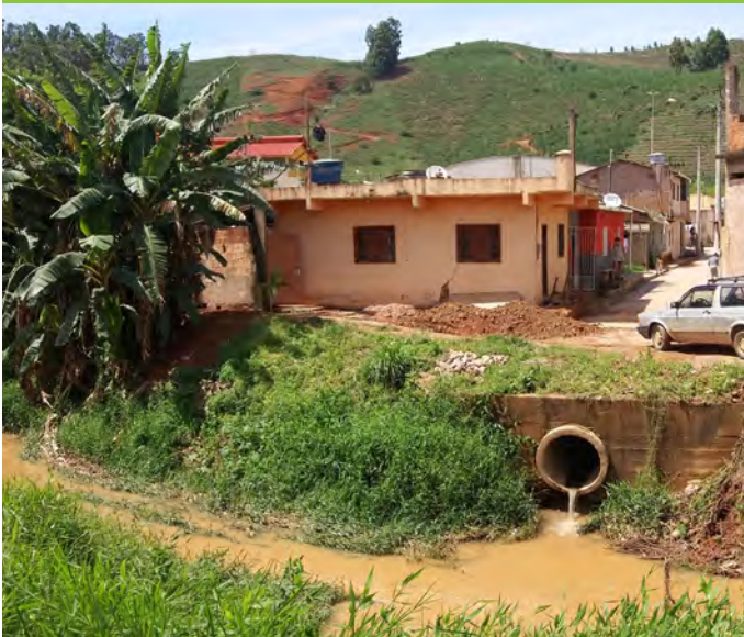
Foto 7: O rio Pardo assoreado, com águas barrentas e com esgoto sendo jogado sem nenhum tipo de tratamento.
