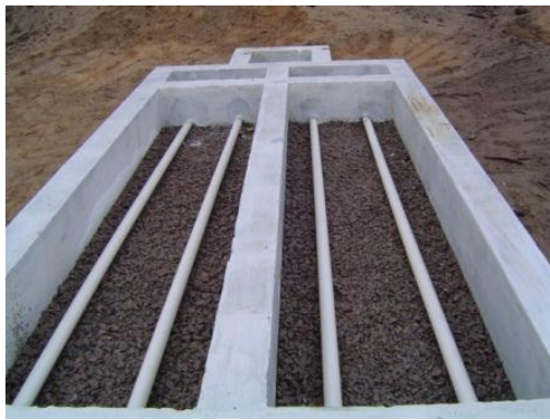
Figura 1: Biofiltros Submersos na época da construção
