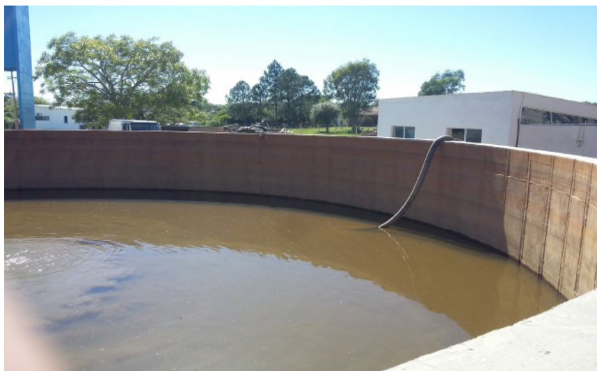
Figura 1 – Tanque de equalização do lodo.
