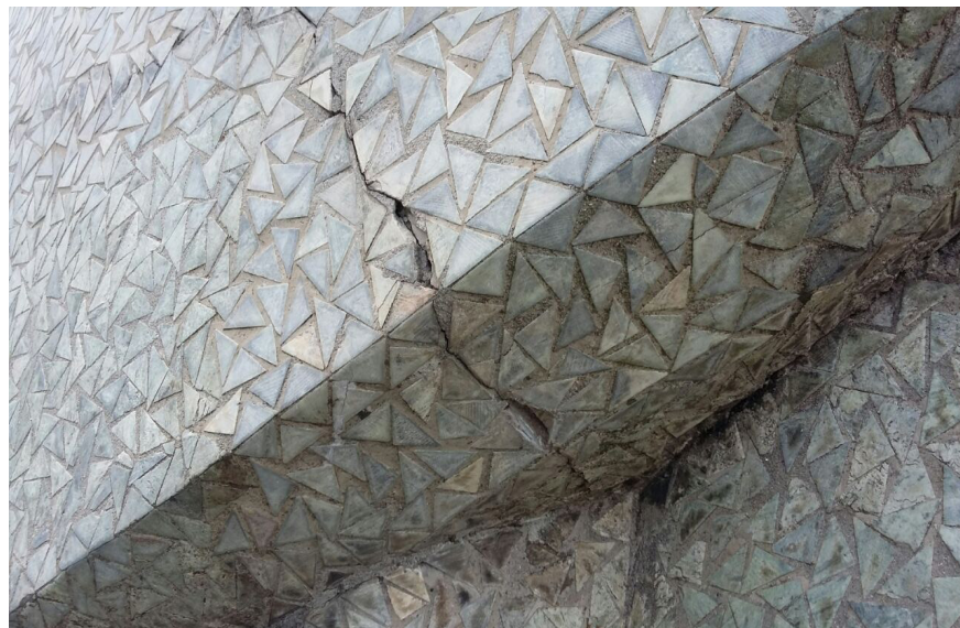
Figura 18: Detalhe do dano. Foto Cristina Ventura, abril de 2017
