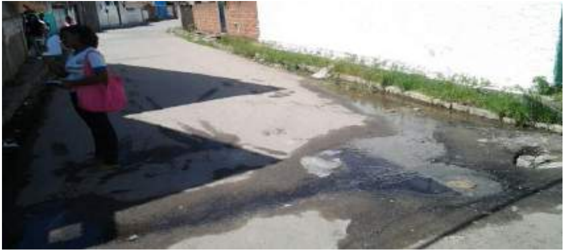
Foto 16: Bueiro estourado no final da Rua Pajussara
