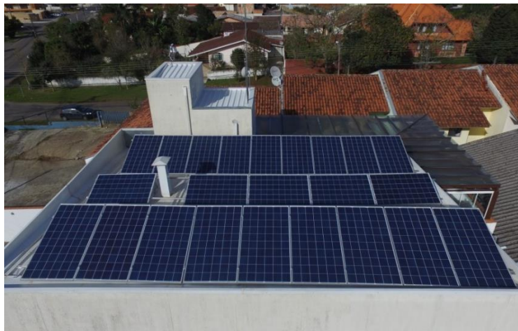
Figura 2.27 - Placa fotovoltaica instalada no teto de uma residência. Fonte: https://goo.gl/images/Jtwi2D
