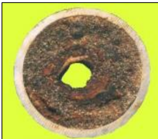
Figura 1 - Entupimento causado por deposição de orgânicos pesados .
