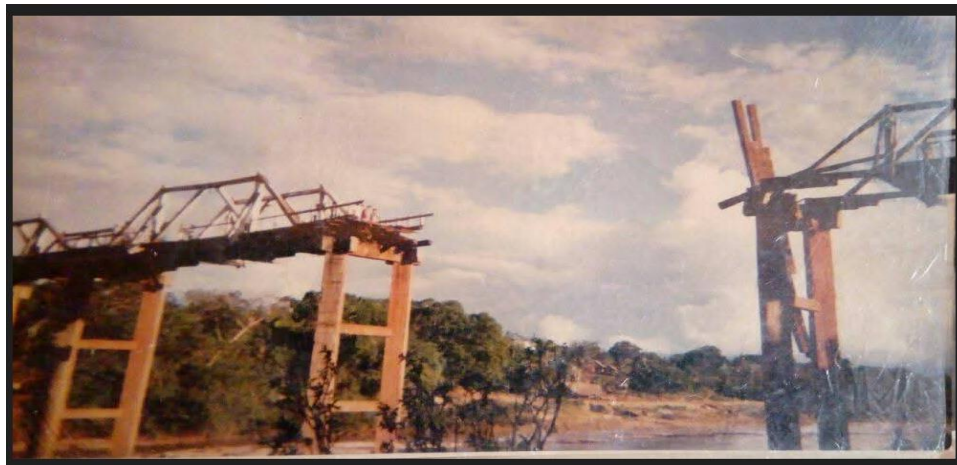
Imagem 2 - Queda do madeiramento da “Ponte da União”. Fonte: Torixoréu: fatos e fotos (Acessado em 16/06/2025)
