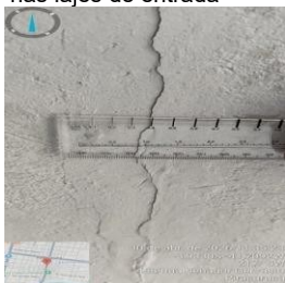
Figura 43 – Fissuras transversais nas lajes de entrada
