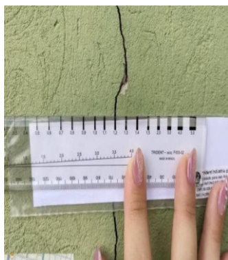
Figura 05 – Mensuração de Fissuras.
