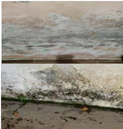
Figuras 05 e 06 - Eflorescência e Mofo em Paredes.
