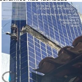
Figura 40 – Deslocamento cerâmico nas fachadas
