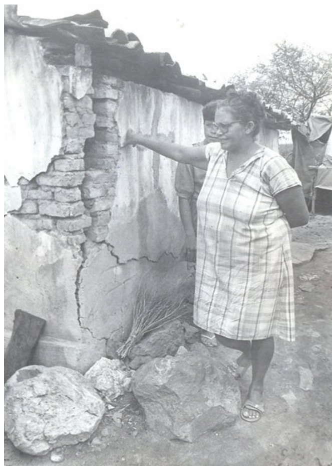
Figura 4 – Danos causados a uma residência. Foto cedida por Cosme Souza.
