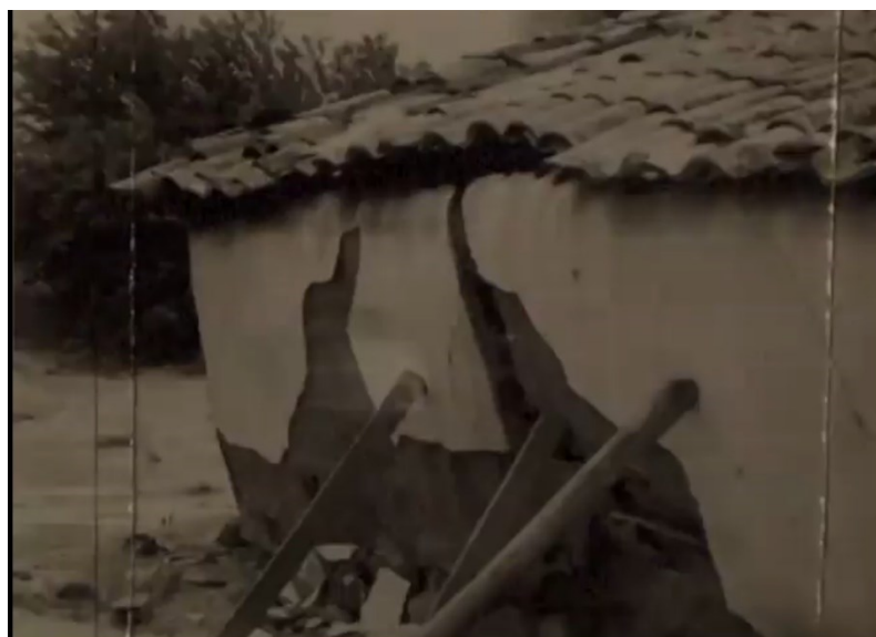
Figura 3 – Casa danificada. Imagem retirada da reportagem em comemoração aos trinta anos dos abalos em João Câmara pela TV Ponta Negra em 30/11/2016. Disponível em https://youtu.be/daYakyvuq-c Acesso em 20 set. 2021.
