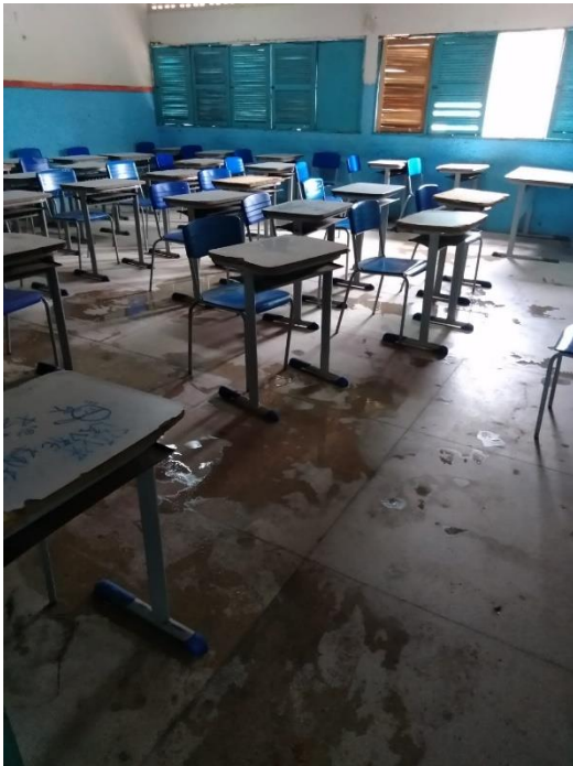
FIGURA 8 – UMA SALA DE AULA DA EEEB ALAGADA APÓS A CHUVA
