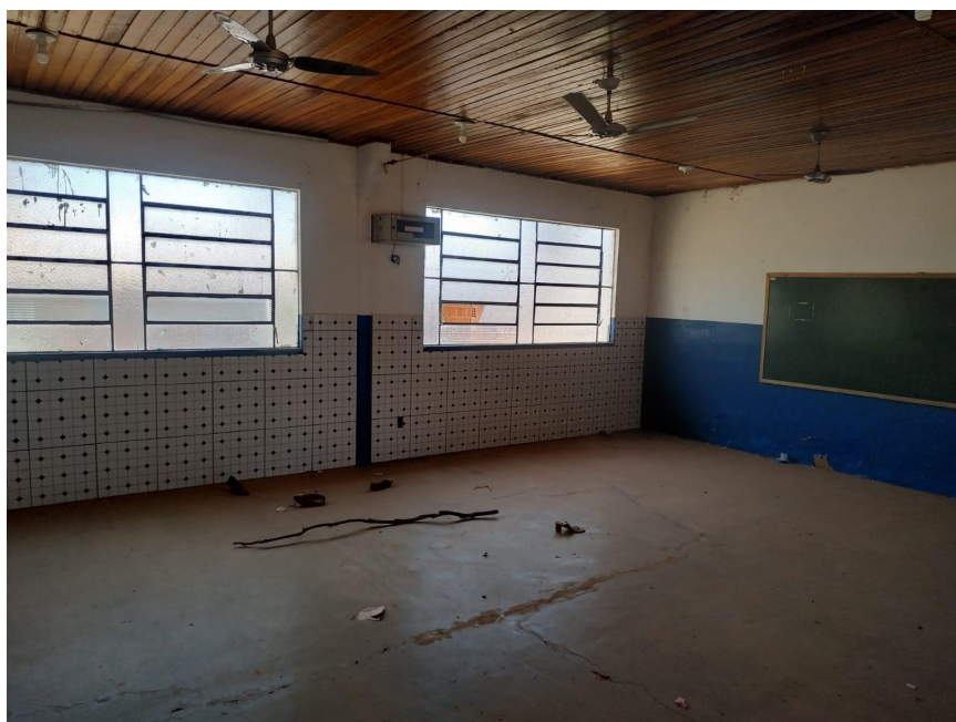
Figura 3 – Vista interna de sala de aula, evidenciando estado de conservação da estrutura, forro, iluminação e mobiliário fixo (registro fotográfico, 2025).
