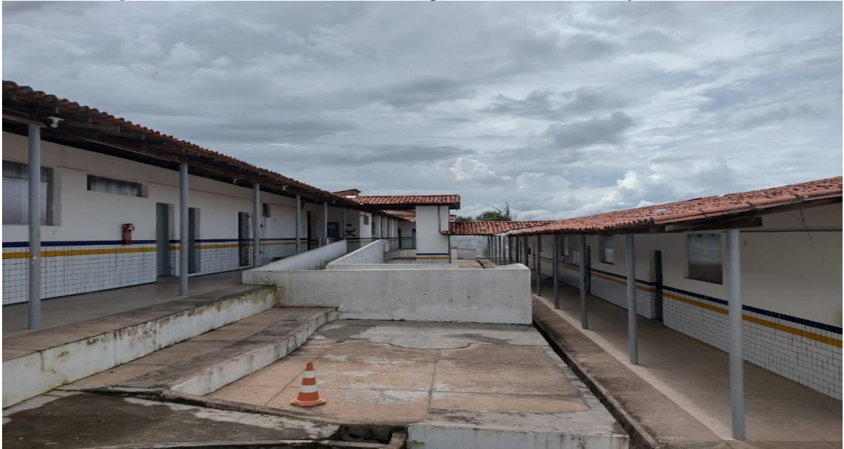
Figura 9 - Corredores das salas de aula/rampa e escadaria da UEB Odylo Costa Filho
