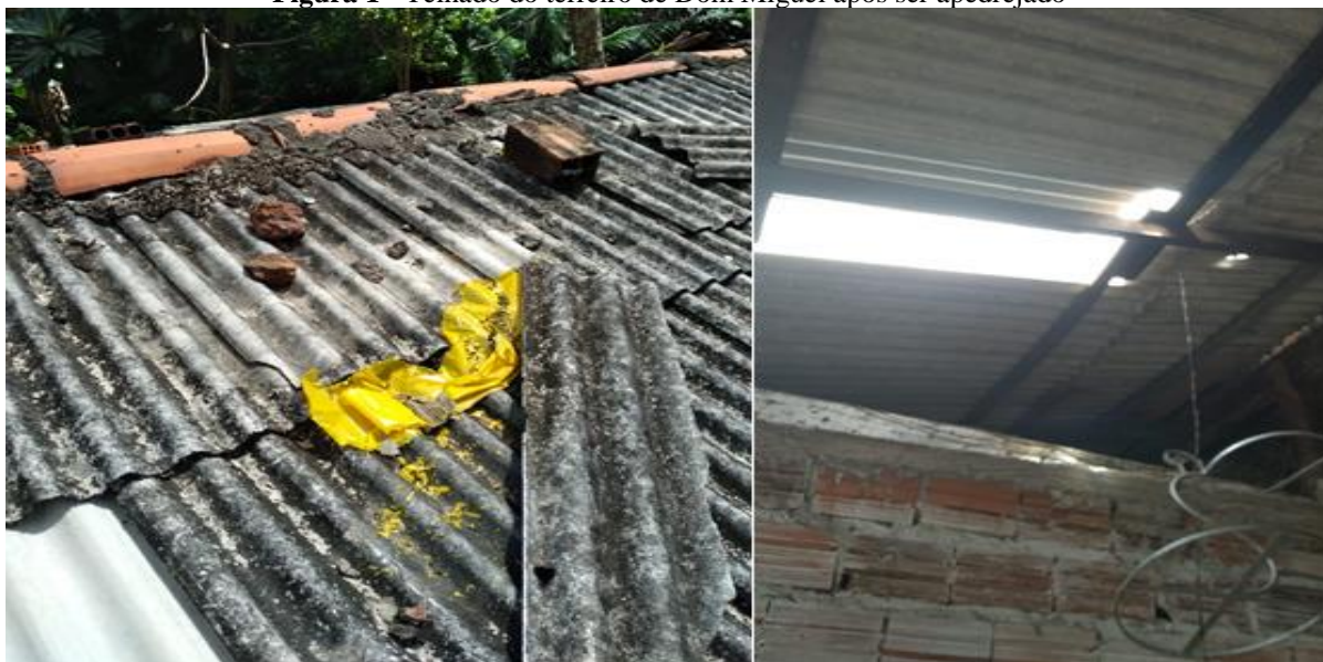
Figura 1 - Telhado do terreiro de Dom Miguel após ser apedrejado
