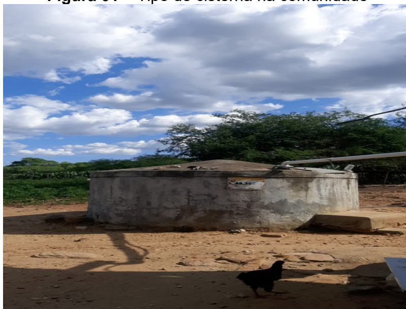
Figura 01 – Tipo de cisterna na comunidade
