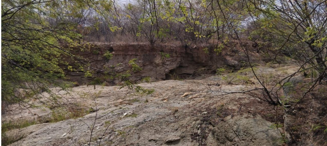
Figura 2. Erosão as margens do rio no ponto 2
