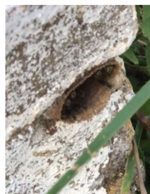
Figura 3: Colmeia de Iraí na caixa de energia
